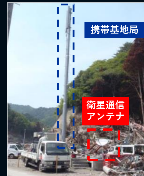
災害現場の携帯移動基地局
