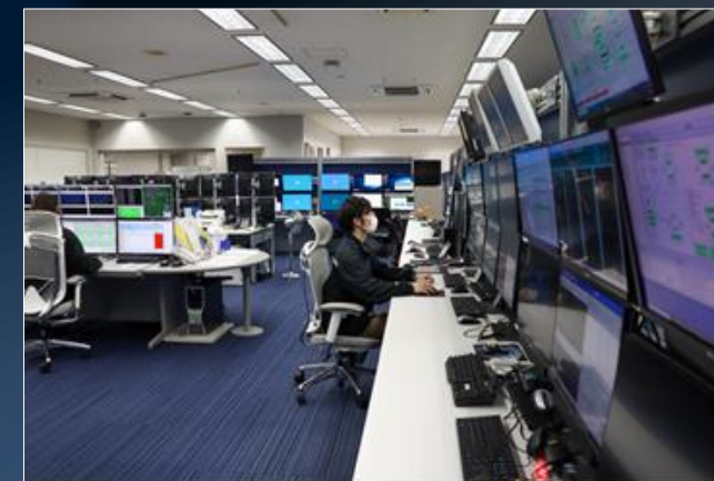
横浜衛星管制センター内管制室
